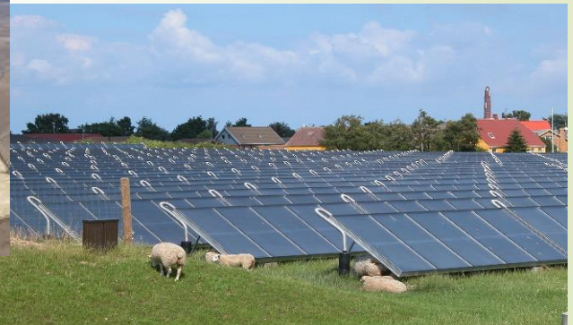
Flachkollektorenfeld Quelle: Nahwärmeversorgung Marstal
