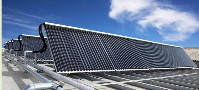
Vakuüm Röhrenkollektorfeld Quelle: Ritter Solar XL
