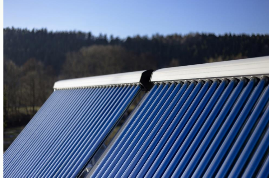
Solarthermie – hier Vakuumröhrenkollektoren
